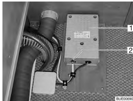
Fig. 166 Trasformatore per riscaldamento elettrico del pavimento
