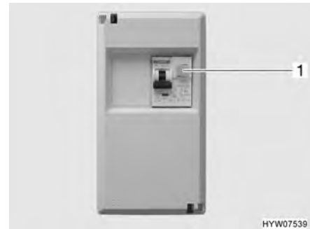
Afb. 146 230-V-zekeringenkast met leiding- en aardlekschakelaar (FI)
