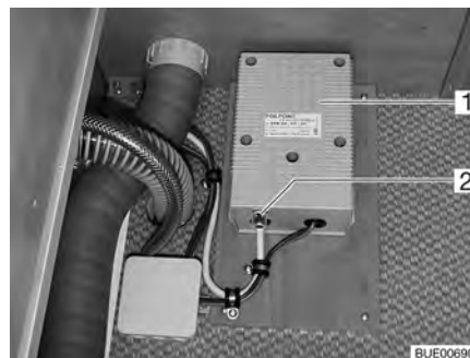
Afb. 166 Transformator voor de elektrische vloerverwarming
