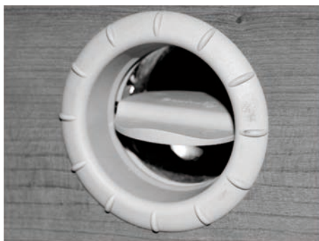
Fig. 128: Bocchetta dell'aria calda aperta
