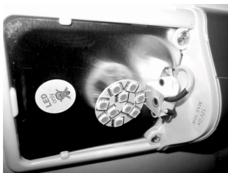
Fig. 161: Sostituire i corpi illuminanti a LED
