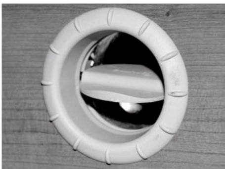
Fig. 84: Bocchetta dell'aria calda aperta
