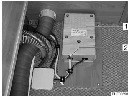
Bild 205 Transformator för elektrisk golvvärme
