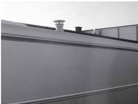
Afb. 82: Schoorsteen voor verbrandingsgassen van de gasverwarming
