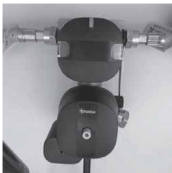
Afb. 76: Gasinstallatie (met Eis-Ex en display op afstand)
