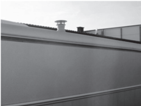
Fig. 78: Chimenea de gases de escape de la calefacción a gas
