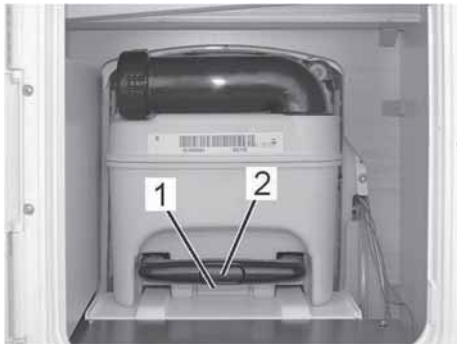
Fig. 123: Serbatoio acque nere nel vano WC
