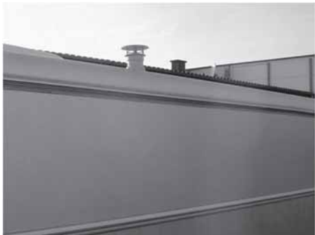
Afb. 74: Schoorsteen voor verbrandingsgassen van de gasverwarming
