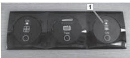
Abb. 79: Ein-/Aus-Schalter der Fußbodentemperierung
