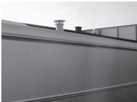
Abb. 78: Abgaskamin der Gasheizung
