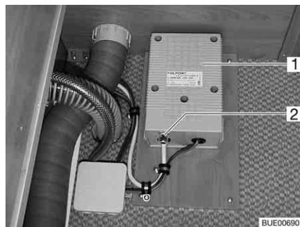
Bild 154 Transformator för elektrisk golvvärme
