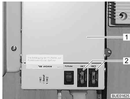
Fig. 125 Régulateur du chauffage des conduites des eaux usées
