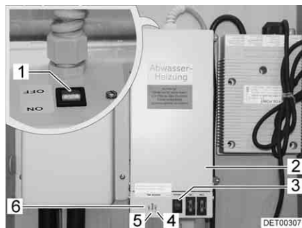
Fig. 147 Transformateur avec régulateur
