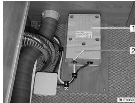
Fig. 148 Trasformatore per riscaldamento elettrico del pavimento
