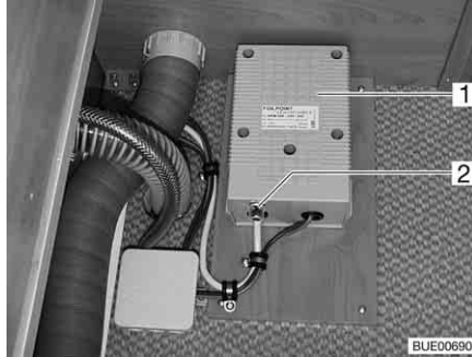
Kuva 108 Sähköisen lattialämmityksen muuntaja
