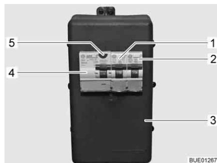
Kuva 89 230 V:n sulakerasia ja johdinsuojajakytkin sekä FI-kytkin
