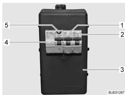
Fig. 94 Scatola dei fusibili a 230 V con interruttore di sicurezza e interruttore automatico FI
