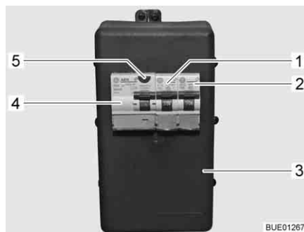
Afb. 94 230-V-zekeringenkast met beveiligingsautomaat en FI-schakelaar
