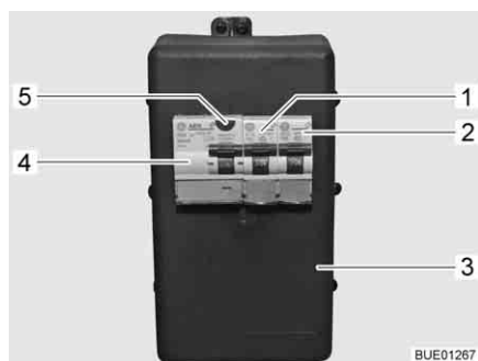
Billede 99 230 V-sikringskabinet med sikkerhedsafbryder og HFI-afbrydere
