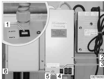
Billede 116 Transformator med reguleringsapparat
