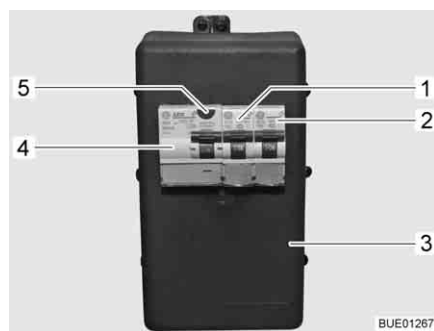
Billede 94 230 V-sikringskabinet med sikkerhedsafbrydere og HFI-afbrydere
