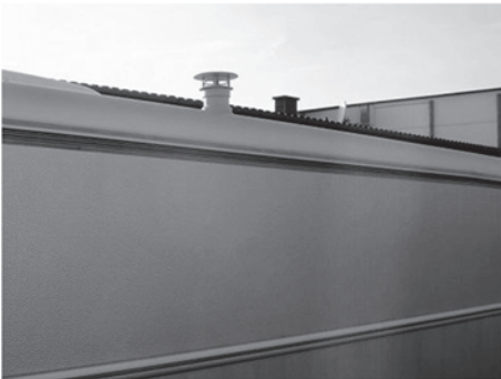
Afb. 83: Schoorsteen voor verbrandingsgassen van de gasverwarming
