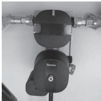
Afb. 77: Gasinstallatie (met Eis-Ex en display op afstand)
