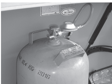
Fig. 101: Gasflaske med trykreduktionsventil
