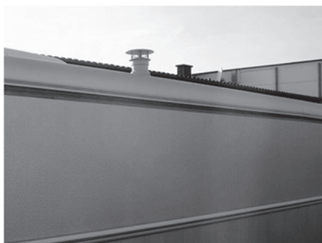
Fig. 83: Conduit d'évacuation des gaz brûlés du chauffage à gaz
