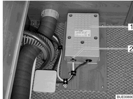
Afb. 224 Transformator voor de elektrische vloerverwarming
