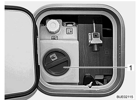
Kuva 284 Vesisäiliön puhdistusaukko (huoltoyksikkö)
