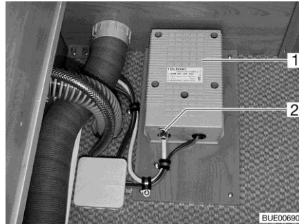
Kuva 224 Sähköisen lattialämmityksen muuntaja
