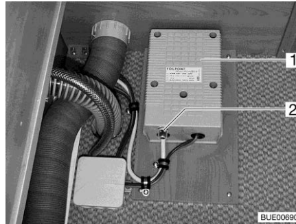
Billede 224 Transformator for elektrisk gulvopvarmning
