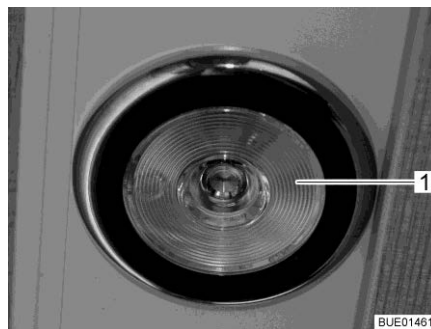
Bild 79 Infälld lampa, ljusbrytare i lampan
