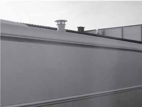
Fig. 82: Avgassrør for gassvarmen
