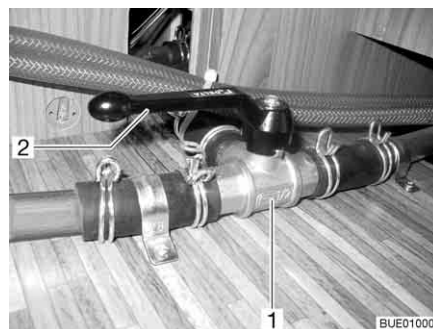
Fig. 201 Válvula de 3 vías
