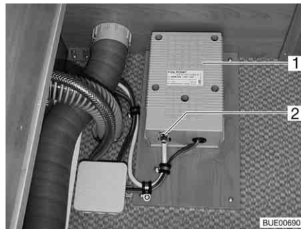
Fig. 209 Transformador para calentamiento eléctrico del piso
