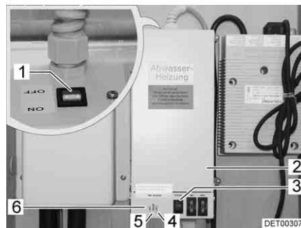
Fig. 116 Transformateur avec régulateur
