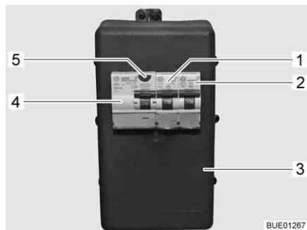
Fig. 94 Coffret de fusibles 230 V avec disjoncteur de protection de circuit et disjoncteur FI
