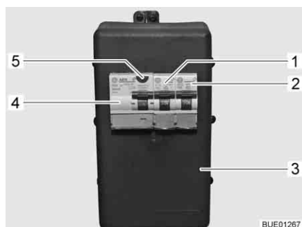
Fig. 99 Coffret de fusibles 230 V avec disjoncteur de protection de circuit et disjoncteur FI
