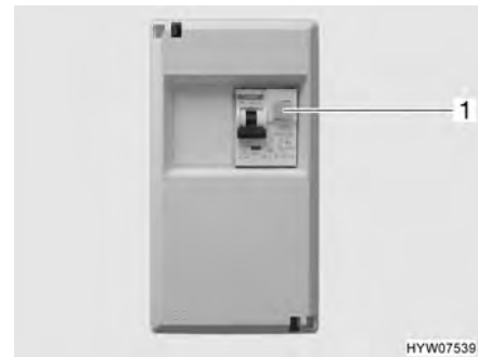
Fig. 105 Coffret de fusibles 230 V avec disjoncteur de protection de circuit et différentiel (disjoncteur FI)
