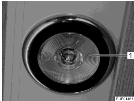
Bild 61 Einbauleuchte, Lichtschalter in der Leuchte
