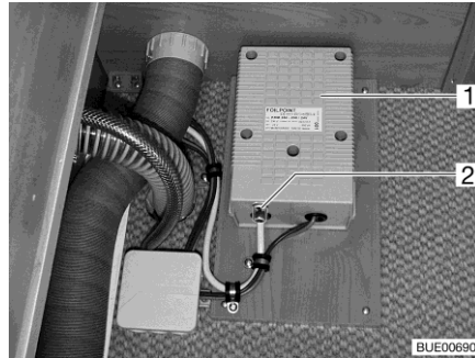
Bild 244 Transformator för elektrisk golvvärme
