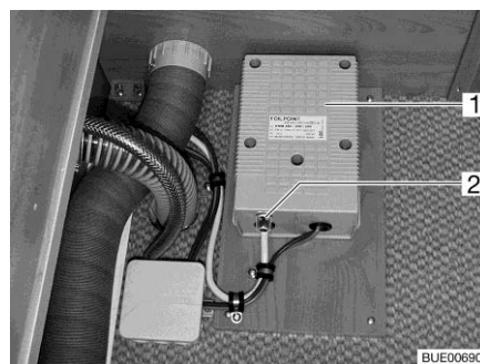
Kuva 147 Sähköisen lattialämmityksen muuntaja
