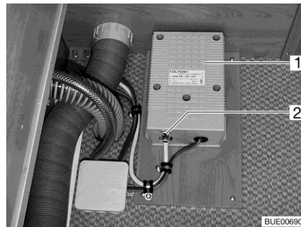
Afb. 244 Transformator voor de elektrische vloerverwarming
