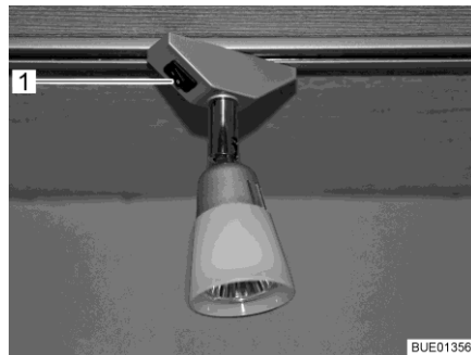
Afb. 75 Spotlight, lichtschakelaar direct bij de lamp
