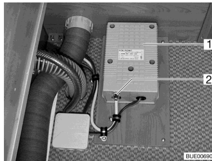
Kuva 244 Sähköisen lattialämmityksen muuntaja
