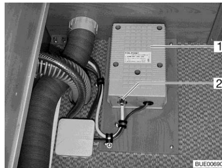
Afb. 233 Transformator voor de elektrische vloerverwarming
