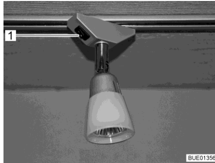
Bild 73 Spotlight, ljusbrytare direkt på lampa
