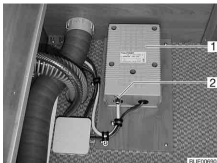
Fig. 205 Transformateur du chauffage électrique du plancher
