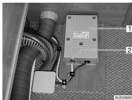
Fig. 205 Trasformatore per riscaldamento elettrico del pavimento
