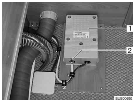
Afb. 144 Transformator voor de elektrische vloerverwarming
