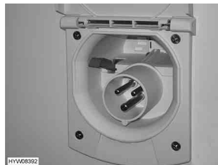
Afb. 121 230-V-aansluiting op het voertuig
