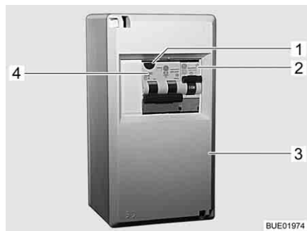
Afb. 120 230-V-zekeringenkast met beveiligingsautomaat en FI-schakelaar
