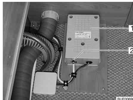
Billede 176 Transformator for elektrisk gulvopvarmning
