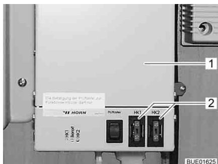
Fig. 147 Régulateur du chauffage des conduites des eaux usées
