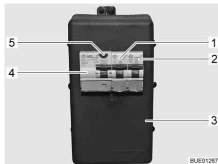
Fig. 140 Coffret de fusibles 230 V avec disjoncteur de protection de circuit et disjoncteur FI
