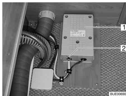
Bild 178 Transformator för elektrisk golvvärme
