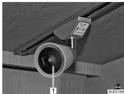
Fig. 187 Ventouse pour changement de lampe
