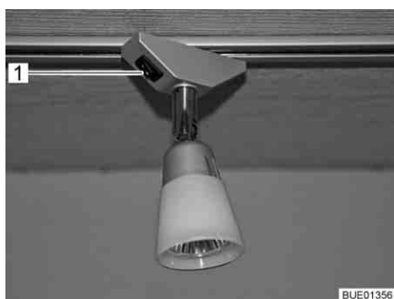
Fig. 44 Spot, interrupteur d'éclairage directement sur la lampe
