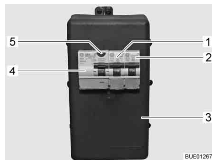
Kuva 142 230 V:n sulakerasia ja johdinsuojajakytkin sekä FI-kytkin
