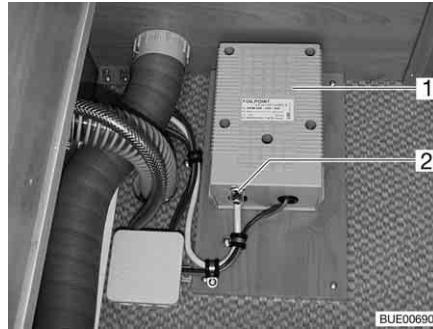
Kuva 174 Sähköisen lattialämmityksen muuntaja
