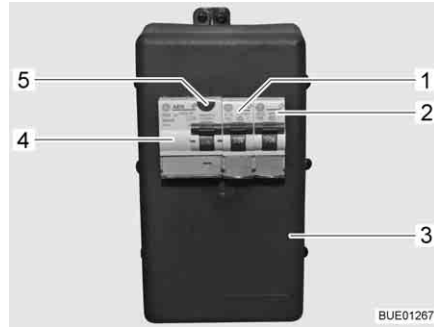
Fig. 142 Coffret de fusibles 230 V avec disjoncteur de protection de circuit et disjoncteur FI
