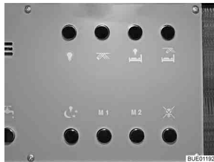
Fig. 68 Panneau de contrôle
