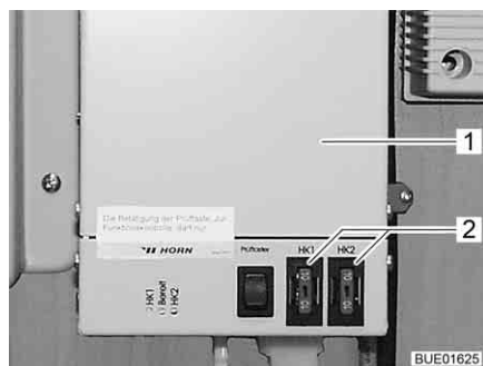
Bild 168 Regler Heizung für Abwasserleitungen
