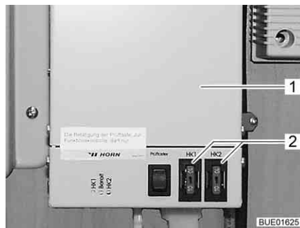
Fig. 168 Régulateur du chauffage des conduites des eaux usées
