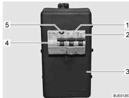
Billede 119 230 V-sikringskab med sikkerhedsafbryder og HFI-afbrydere
