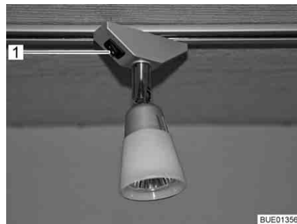
Billede 45 Spotlampe, lyskontakt direkte ved lampen
