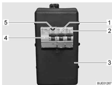
Billede 109 230 V-sikringsskab med sikkerhedsafbryder og HFI-afbrydere
