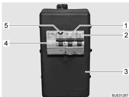
Kuva 160 230 V:n sulakerasia ja johdinsuojajakytkin sekä FI-kytkin
