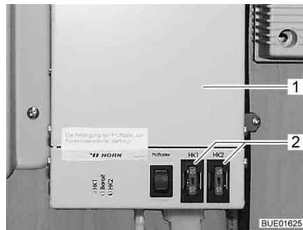
Kuva 168 Jätevesijohtimien lämmityksen säädin
