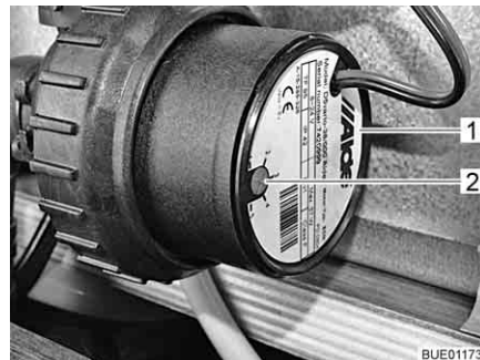
Kuva 200 Kierrätyspumpun kierrosluvun pienentäminen
