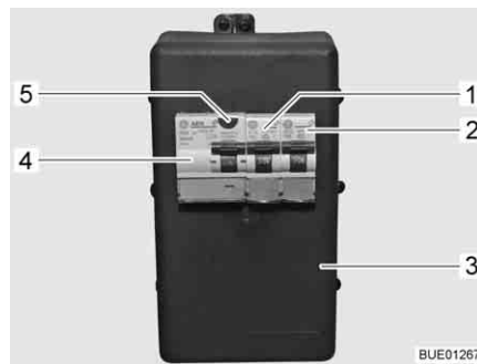
Bild 184 230 V-säkringslåda med ledningsskyddsbrytare och FI-brytare
