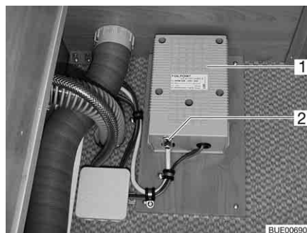
Bild 205 Transformator för elektrisk golvvärme
